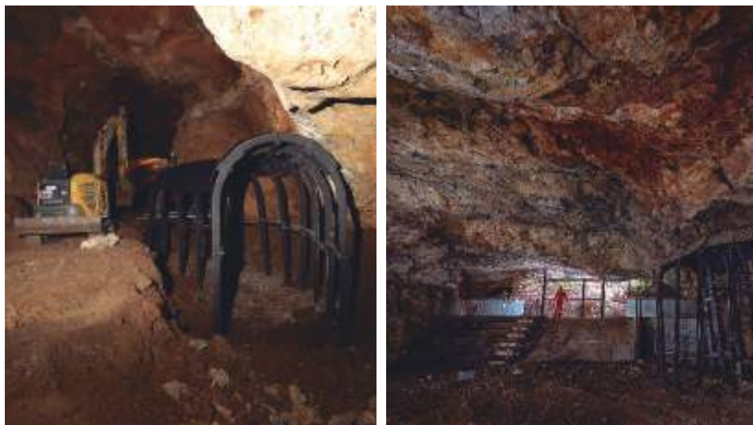
Figura 8. Trabajos de acondicionamiento y seguridad en la mina Victoria (izq). Actuaciones de seguridad y acondicionamiento de galerías y techos en Victoria II (der).
